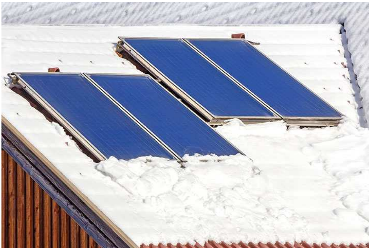
Instalacje energooszczędne - panele fotowoltaiczne
